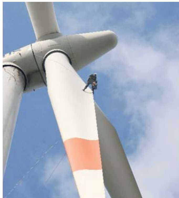
Wer in solch luftiger Höhe an einem Rotorblatt „herumturnt“, muss unbedingt schwindelfrei sein. Fotos bam
